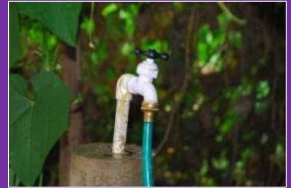
Toma de agua
